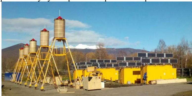
Рисунок 10 – Автономная энергетическая установка на основе ВИЭ
