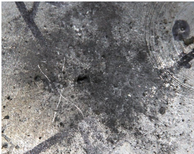
Рисунок 4.15 – Повреждение преграды после срабатывания ВМУ с отсечкой с помощью дополнительного заряда ВВ и сминаемой трубки
