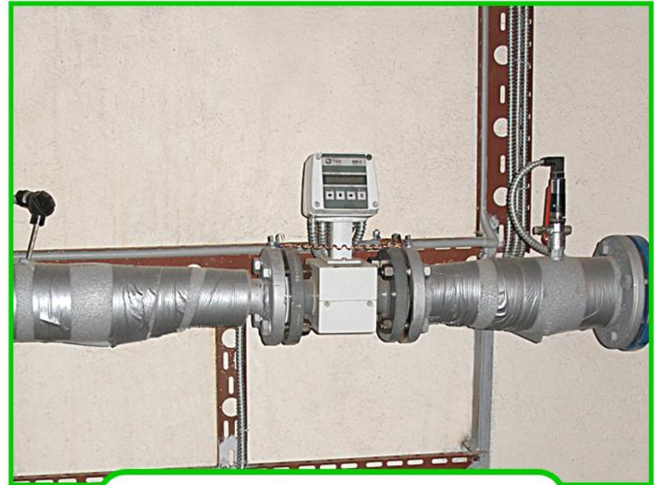
ЦТП после установки приборов учета тепловой энергии
