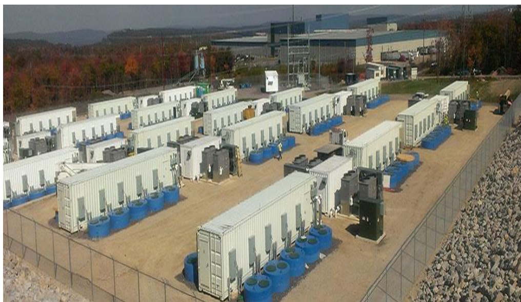
Рисунок 1.1 – Вспомогательная электростанция компании Weason power
