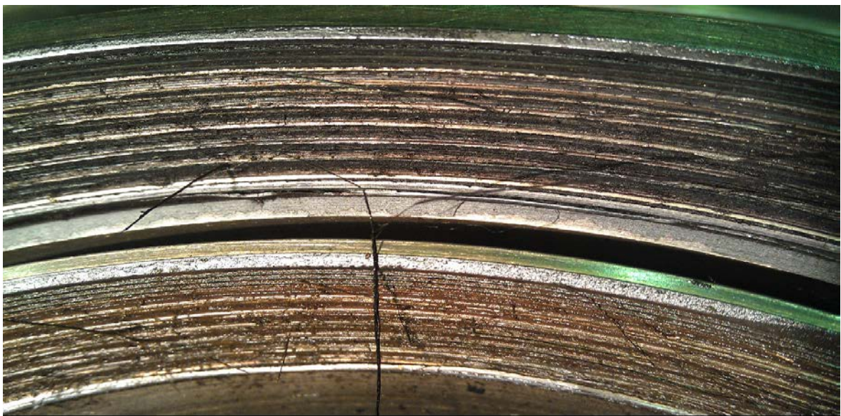
Рисунок 4.3- Состояние лабиринтных уплотнений турбин
