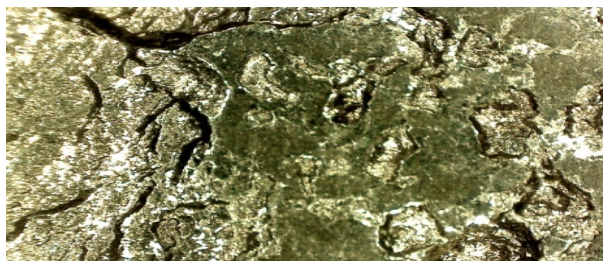
Рисунок 2.6 - Выход трещин на поверхность беговой дорожки наружного кольца
