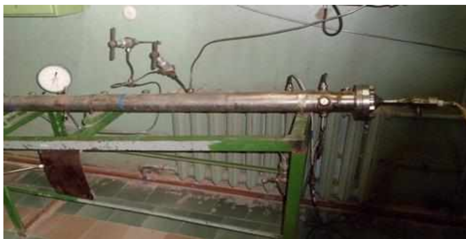
Рисунок 3.13 - Фотография трубы высокого давления (ударной трубы) с присоединённым к ней ЭИВУ
